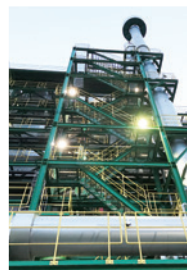
BPS大東龍間発電所 （バイオマス発電）
